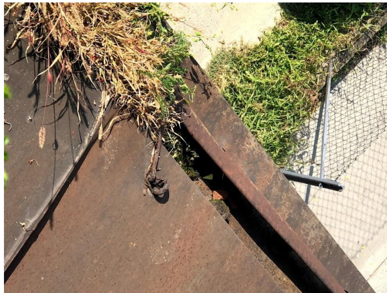
15. Kuczka na kamienicy przy ul. Reformackiej 23A w Chełmie. Dach kuczki widziany z góry. Widoczne ogniwo do mocowania końca linki stalowej oraz element do zaczepiania o dystans, w celu unieruchomienia kłapy w pozycji otwartej (?). fot. Małgorzata Michalska – Nakonieczna, 2022 r.
