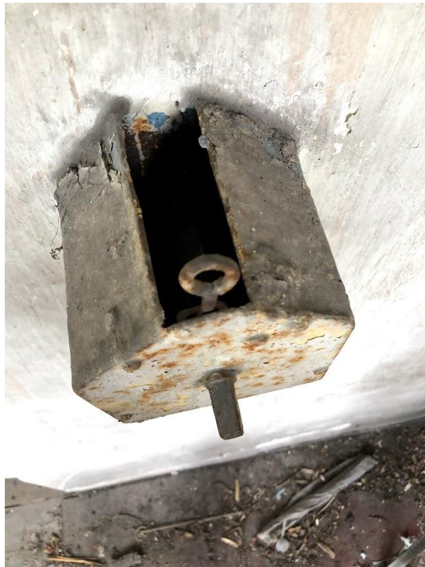
20, 21. Wnętrze kuczki na kamienicy przy ul. Reformackiej 23A w Chełmie. Kołowrotek do podnoszenia kłap w dachu. fot. Małgorzata Michalska – Nakonieczna, 2022 r.
