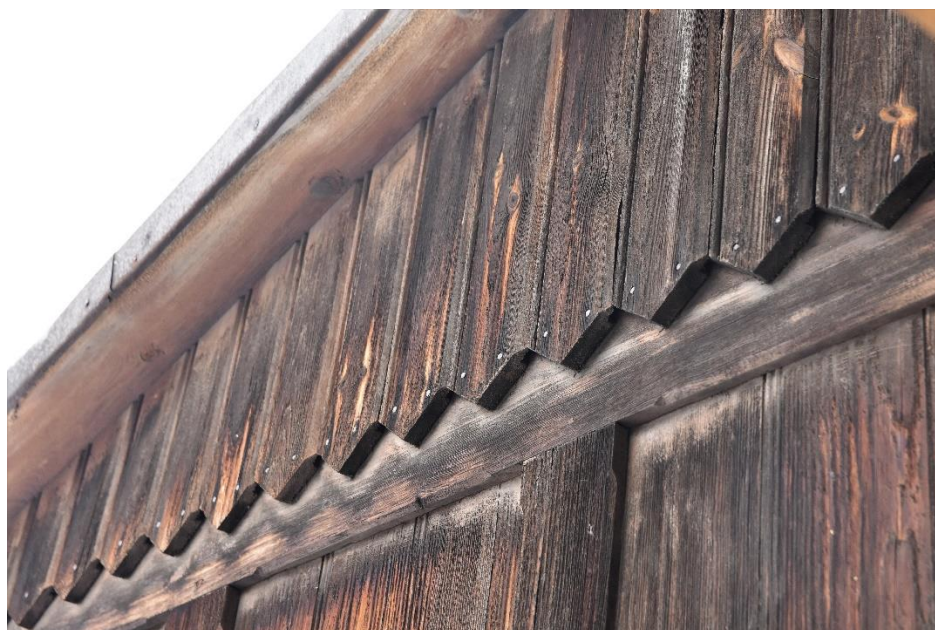
9. Kuczka na kamienicy przy ul. Reformackiej 23A w Chełmie, detal elewacji wschodniej, fot. Małgorzata Michalska – Nakonieczna, 2022 r.
