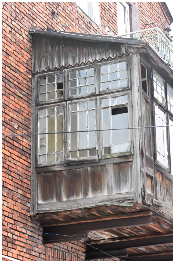
8. Kuczka na kamienicy przy ul. Reformackiej 23A w Chełmie, elewacja zachodnia, fot. Monika Puła, 2022 r.
