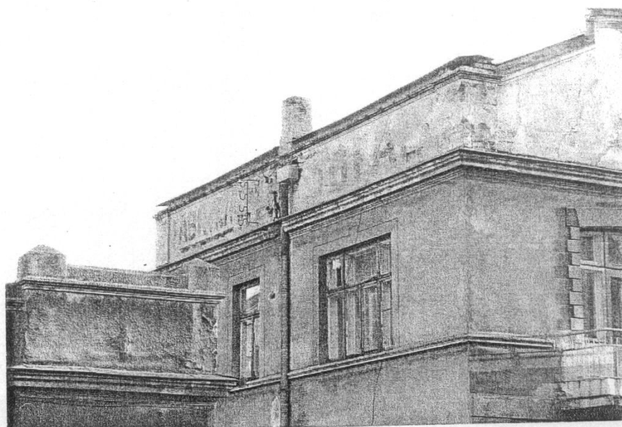
5) D. Fabryka Wag fragment zwieńczenia budynku fabrycznego ze śladami nazwy fabryki IDEAL. Fot. J. Studziński, 1995 ; neg. w posiad. PSOZ Lublin.
