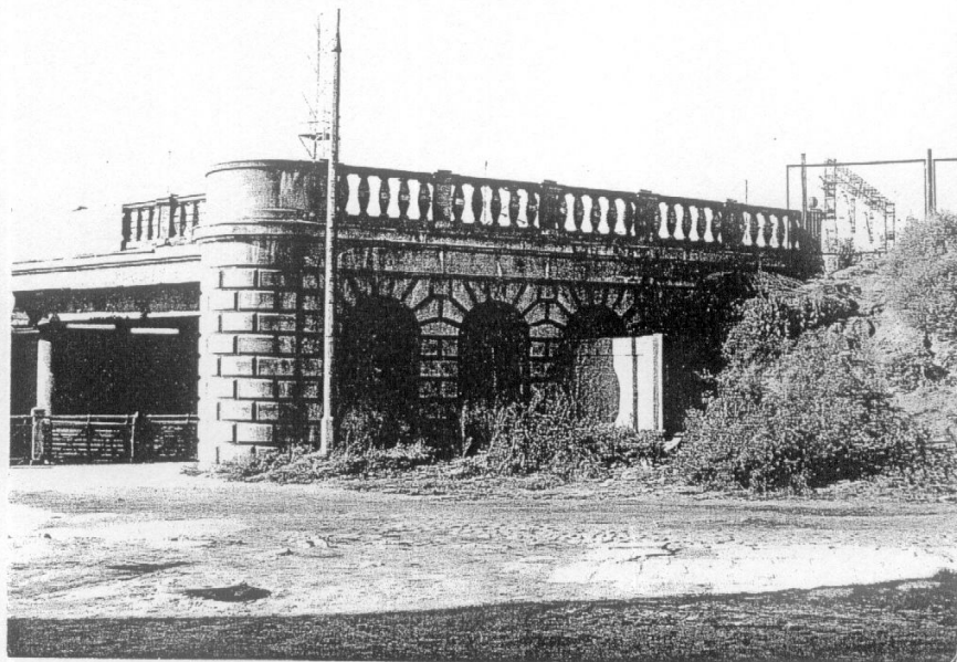
2. Wiadukt na ul. Kunickiego, przyczółek, widok z boku Fot. J. Studziński, 1995 ; neg. w posiad. PSOZ
