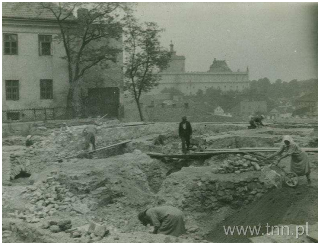
Prace konserwatorskie przy fundamencie dawnego kościoła św. Michała, Grodzka 9/Archidiakońska 11, autor nie znany, 1938, Wydział Architektury, Budownictwa i Urbanistyki Urzędu Miasta Lublin
