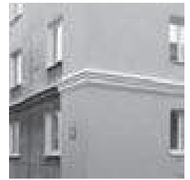
Fragment budynku na osiedlu ZOR-y przy ul. Puchacza z częściowo ocieploną i odnowioną elewacją. Fot. M. Skrzypek.
