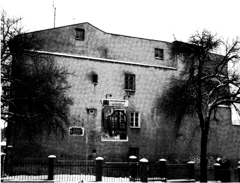
Zachodnia ściana domu nr 9 od strony zabudowań parafialnych. Widoczne ślady zniszczeń i zacieków wymagające remontu
